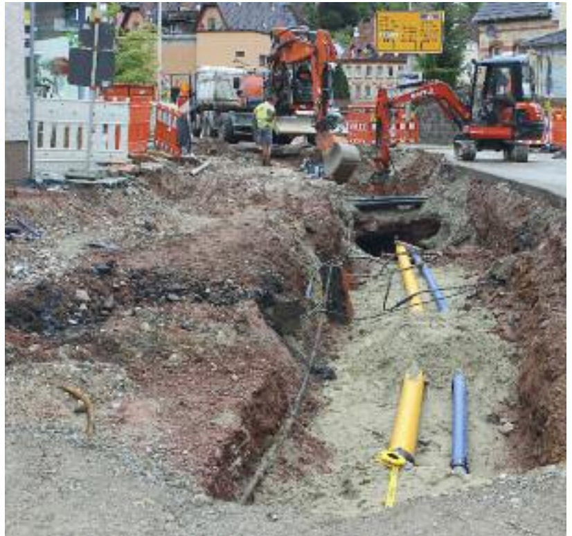
Großbaustelle Oberndorfer Straße: Zwischen Eiscafé Rino und Paradiesplatz werden von den Stadtwerken neue Leitungen für Gas, Wasser und Abwasser verlegt.
