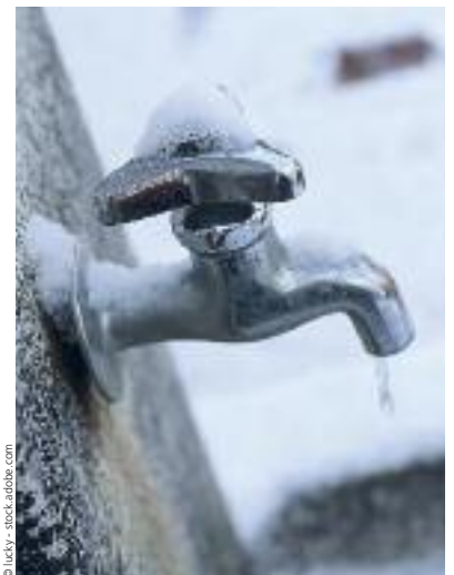
Leitungen, Wasserhähne und Ventile im Außenbereich sollten geleert sein.
