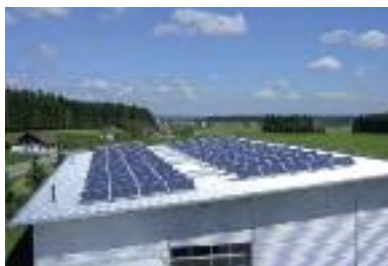
Aktuell betreiben die Stadtwerke sieben Photovoltaikanlagen.
