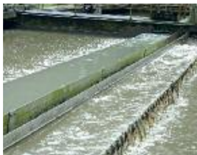
Auf der Schramberger Kläranlage wird das Abwasser mit moderner Technik gereinigt.
